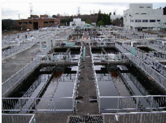
◆水処理施設全景
