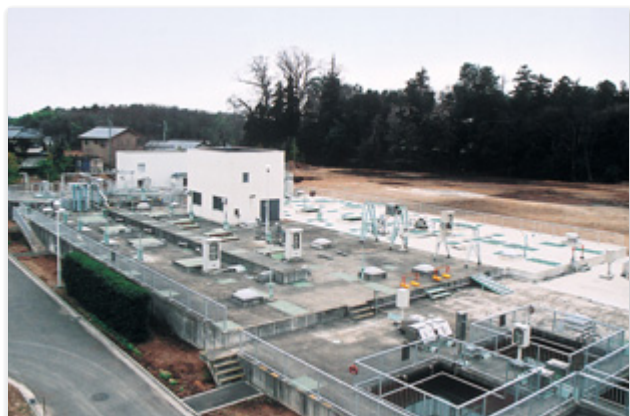
水処理（反応タンク・最終沈殿池）
