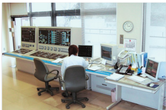
中央監視操作室
