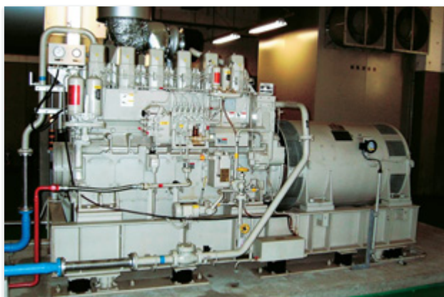
自家用発電機（非常用）
