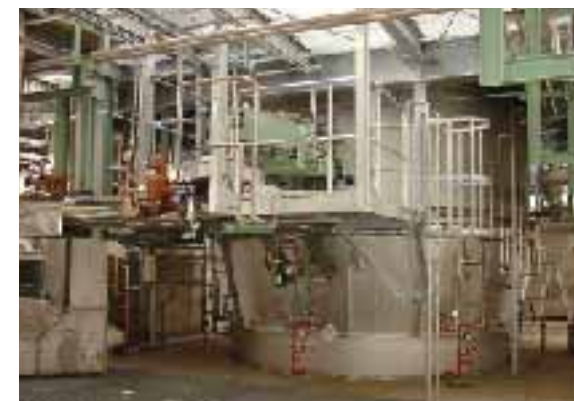
●焼却炉本体 脱水汚泥等を高温で完全燃焼させ、焼却灰にします。
