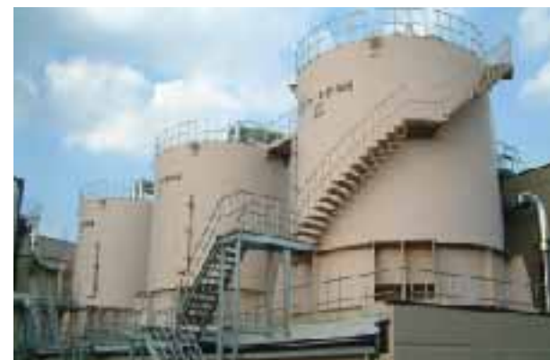
③汚泥貯留サイロ 脱水汚泥を1350㎡(450㎡×3基)貯留し、焼却施設へ安定供給します。
